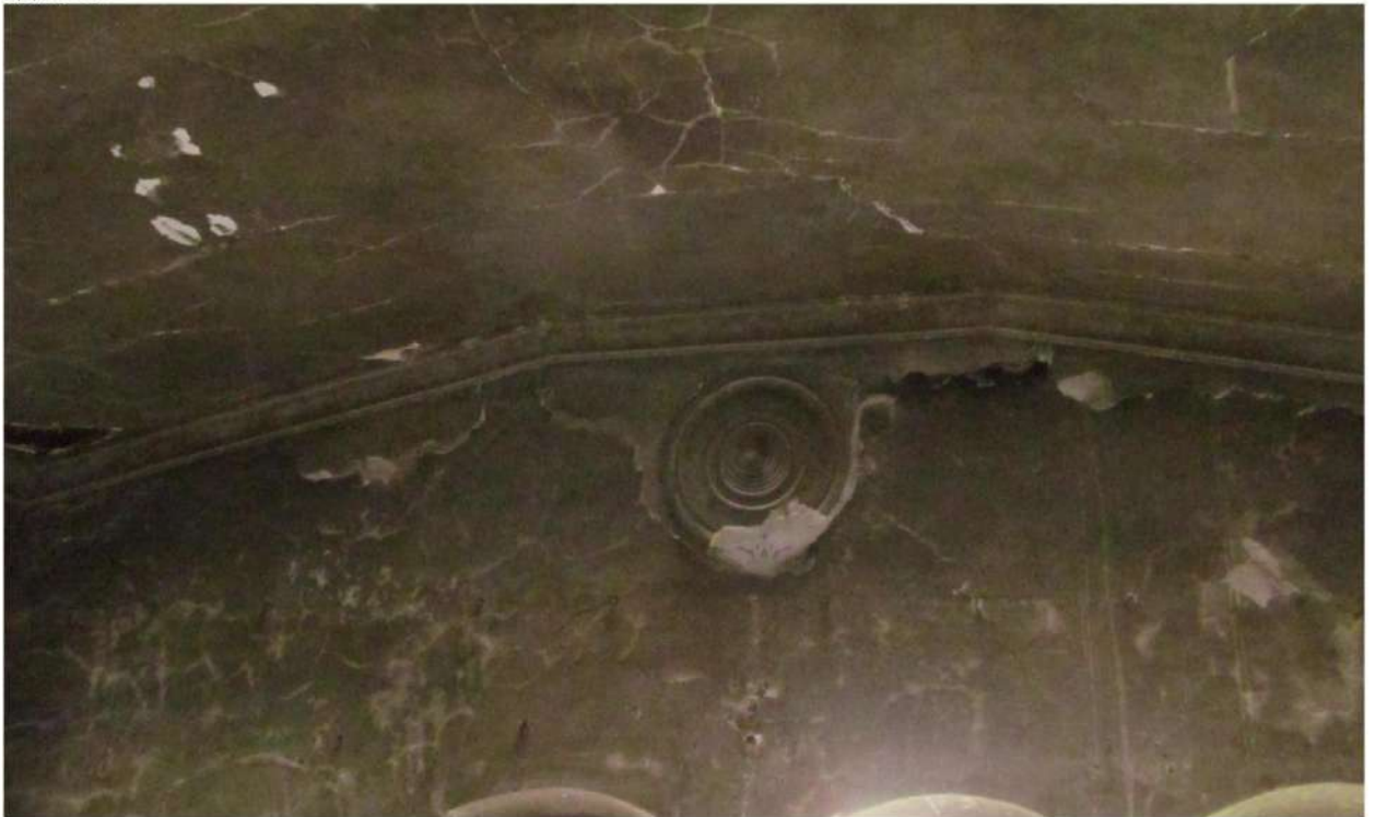
Рис. 32 Вид на состояние потолков и лепнины в западной части основного помещения здания
