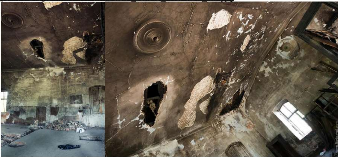
Рис. 46 Интерьеры здания бывшей насосной водопровода «Златоусто-Челябинской» железной дороги по ул.Свободы, 6 (Фото – 2014 г.). Ссылки: http://img-fotki.yandex.ru/get/9804/674039.703/0_c0249_713ffd1f_XL.jpg , http://img-fotki.yandex.ru/get/9804/674039.703/0_c0245_b24bd8b4_XL.jpg .
