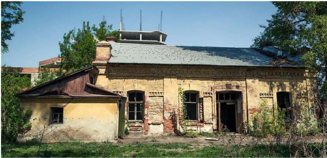
Рис. 42 Южный фасад здания бывшей насосной (водокачки) водопровода «Златоусто-Челябинской» железной дороги (участка Самаро-Златоустовской железной дороги) по ул.Свободы, 6 (Фото – май, 2014 г.). Ссылка: http://img-fotki.yandex.ru/get/9304/674039.703/0_c0250_baa5c535_XL.jpg .
