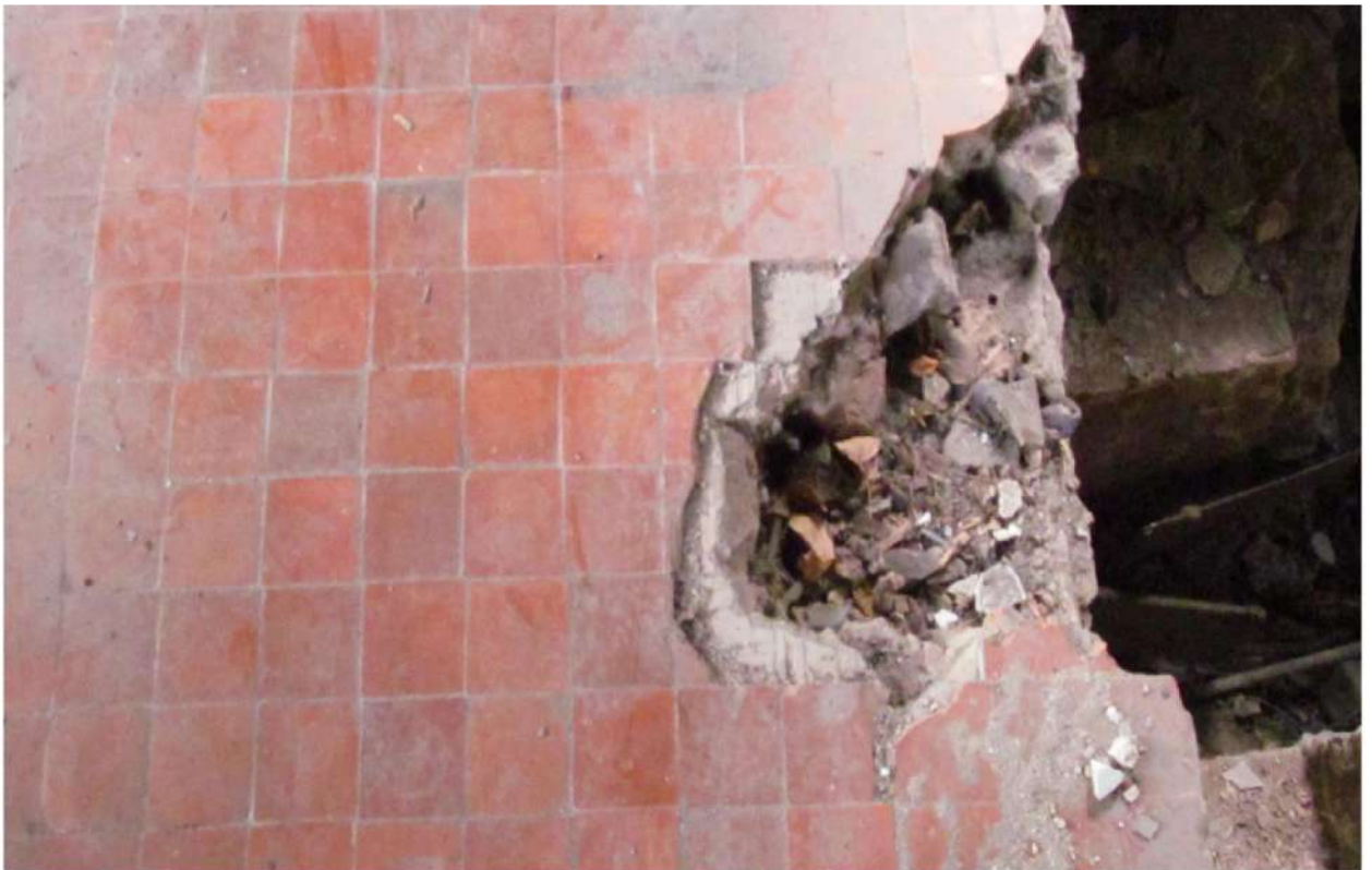
Рис. 35 Вид на состояние полов в западной части основного помещения здания
