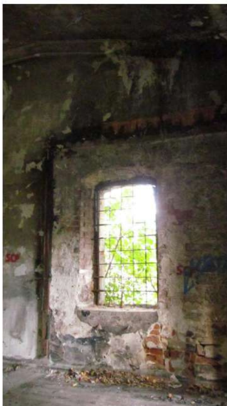
Рис. 36 Вид на состояние стен и оконный проем восточной стены основного помещения здания
