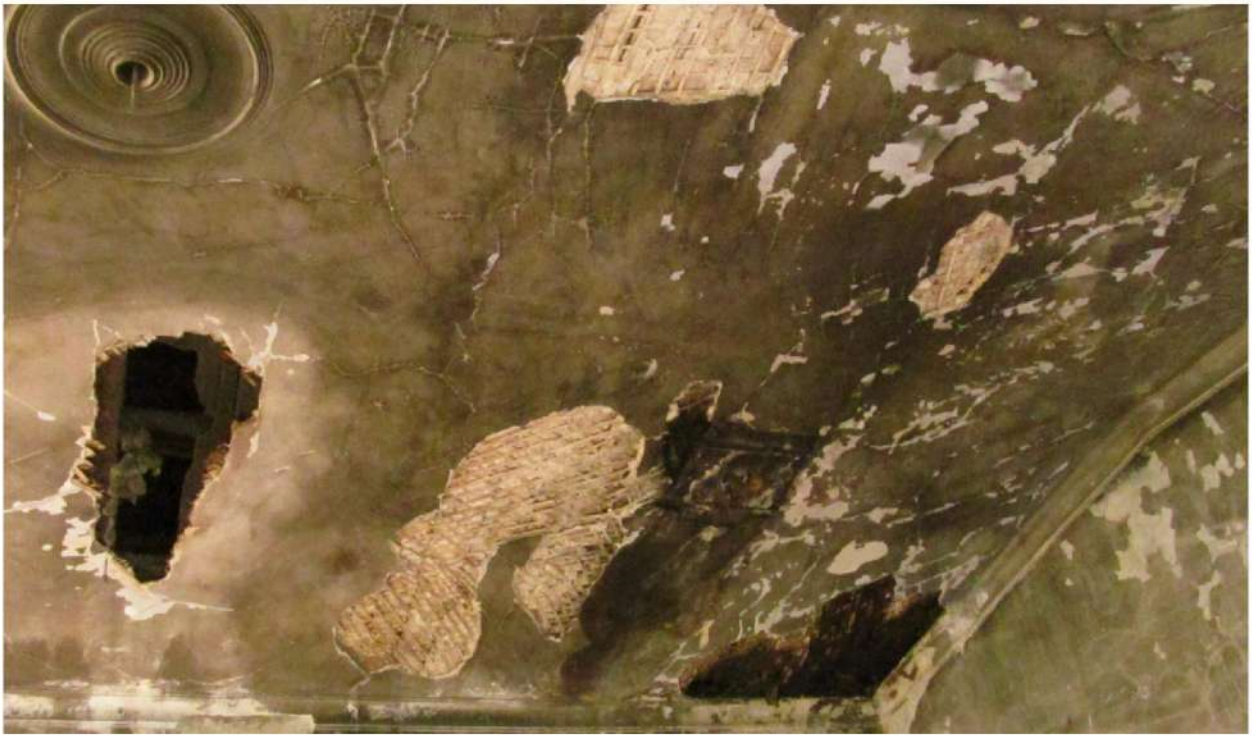
Рис. 31 Вид на состояние потолков и лепнины в восточной части основного помещения здания
