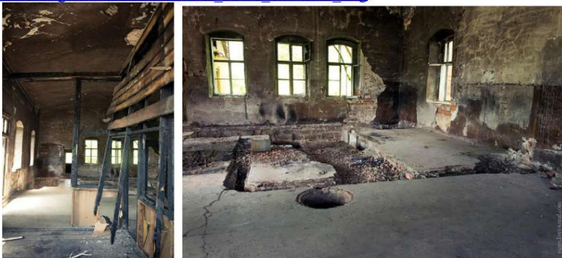
Рис. 44 Интерьеры здания бывшей насосной водопровода «Златоусто-Челябинской» железной дороги по ул.Свободы, 6 (Фото – 2014 г.). Ссылки: http://img-fotki.yandex.ru/get/9804/674039.703/0_c0243_586d9_ea6_XL.jpg , http://img-fotki.yandex.ru/get/9804/674039.703/0_c0248_b31fc742_XL.jpg .
