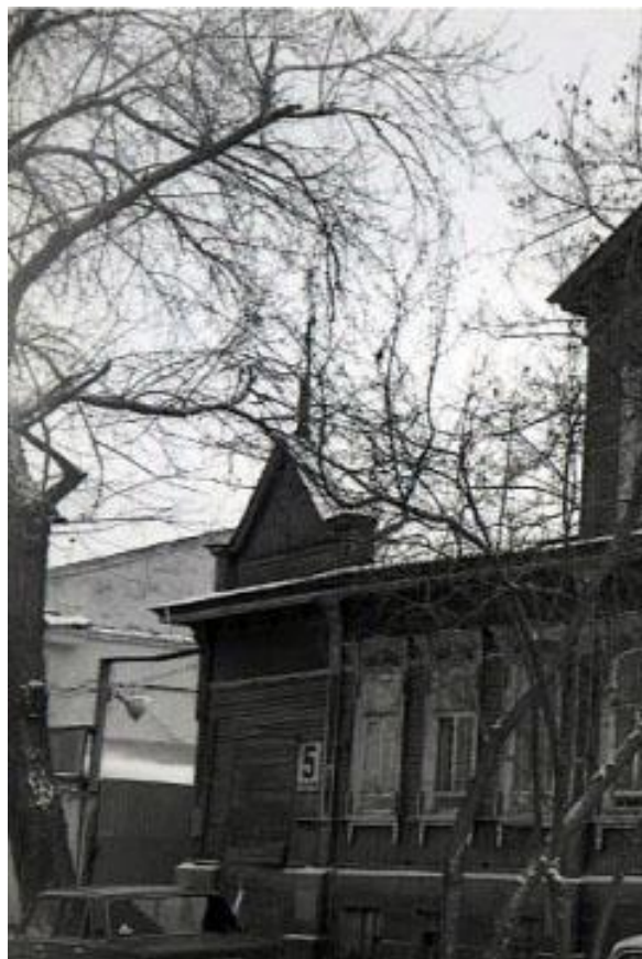
Рис. 21. Фрагмент фото усадебного дома Стахеевых 1980-х гг., на котором виден фрагмент южного фасада выявленного объекта культурного наследия «Каменная кладовая» с отсутствующим декором.
