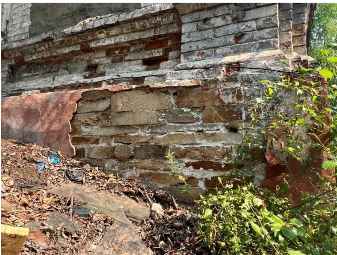
Рис. 20. Бутовая кладка цоколя
