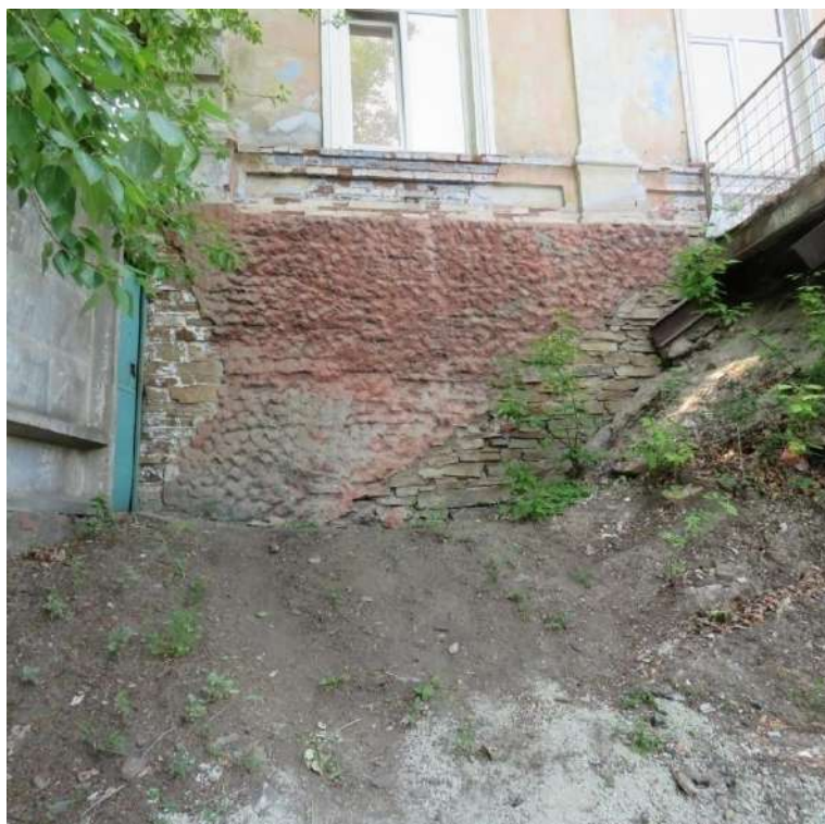
Рис. 6. Отсутствующий левый марш лестницы
