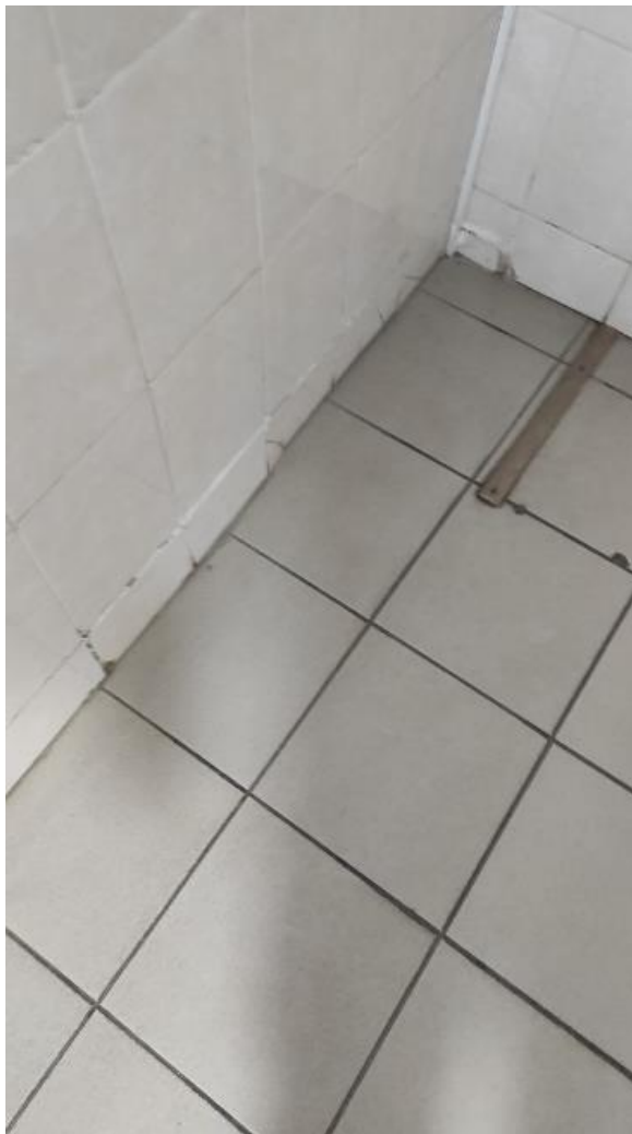
Фото 24. Интерьер выявленного объекта культурного наследия «Банк», расположенного по адресу: Челябинская область, Миасский городской округ, г. Миасс, ул. Спорта, 3.
