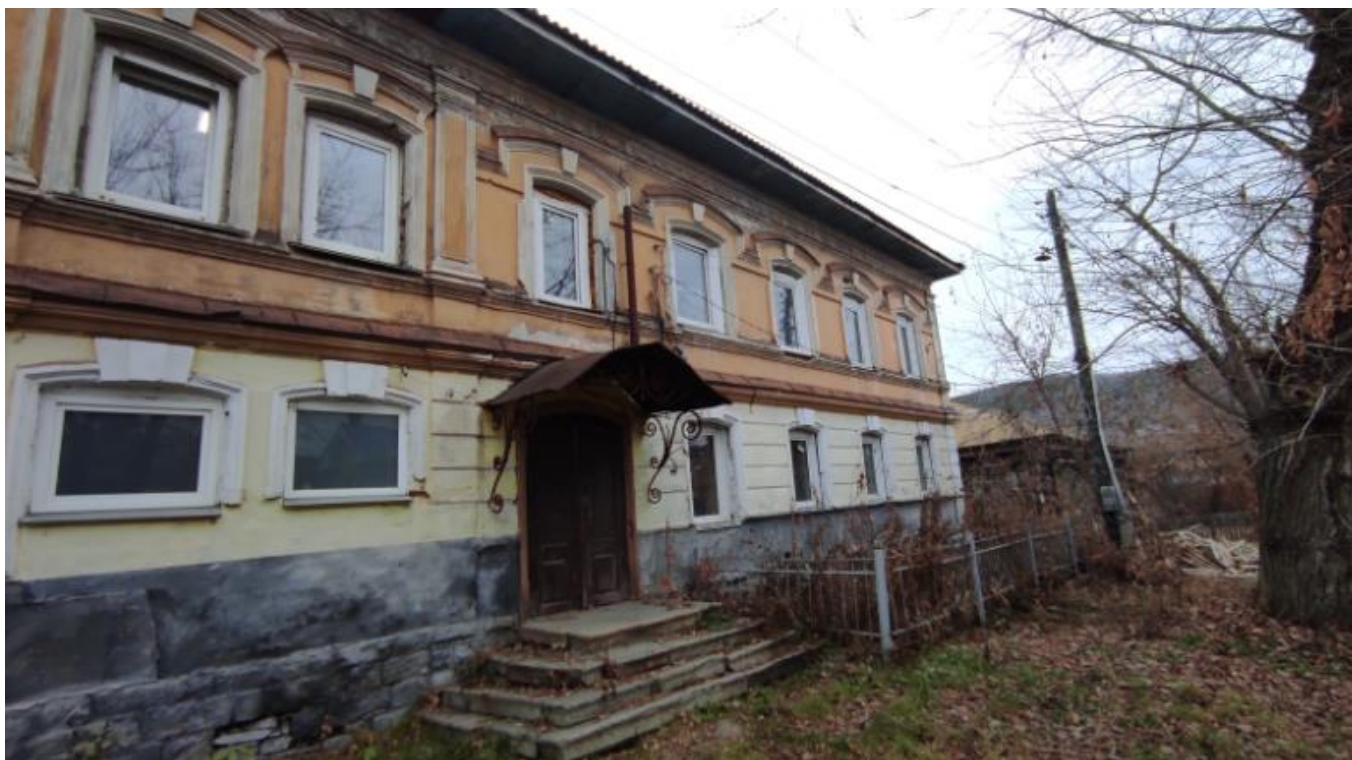
Фото 10. Вид на выявленный объект культурного наследия «Банк», расположенный по адресу: Челябинская область, Миасский городской округ, г. Миасс, ул. Спорта, 3.
