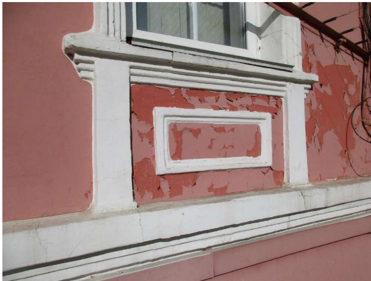
17. Подоконная филенка. Август 2023 г.
