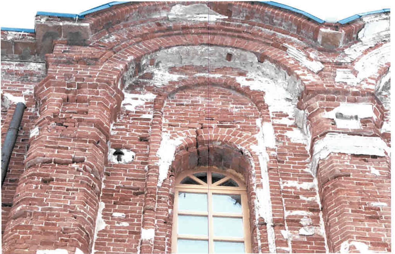
Фото 13. Трещина перемычки окна.
