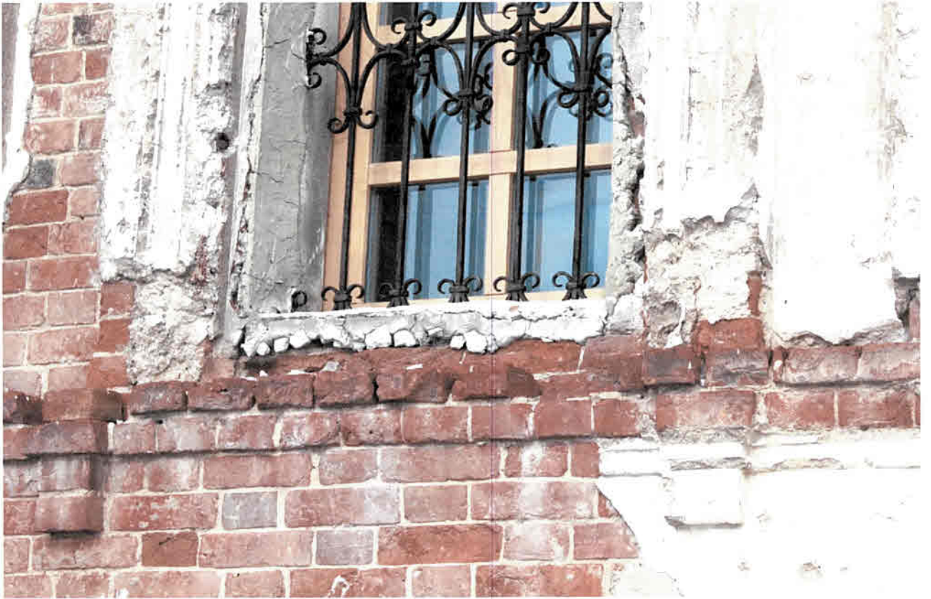
Фото 11. Разрушение оконного обрамления
