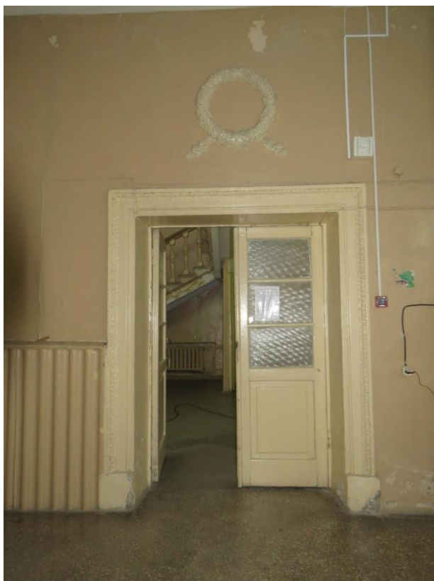
Рис. 30. Цилиндрический объем лекционной аудитории. Дверной проем выхода на лестничную клетку из вестибюля. Фото 2017 г.
