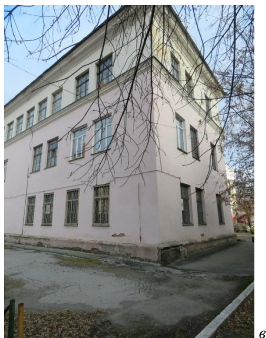
Рис. 27 а,б. Северо-западный фасад юго-западного примыкающего корпуса. На фото «а» обозначен синим контуром, левее – фасад основного, прямоугольного корпуса в. Торцевой, юго-западный фасад
