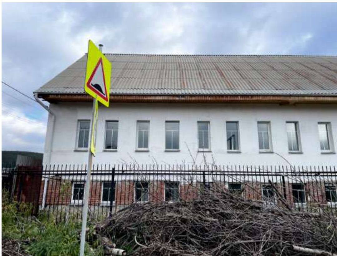
Фото 27. Выявленный объект культурного наследия «Дом купца Лесина» по адресу: Челябинская обл., г. Миасс, ул. Октябрьская, 7. Фрагмент западного фасада выявленного объекта культурного наследия.
