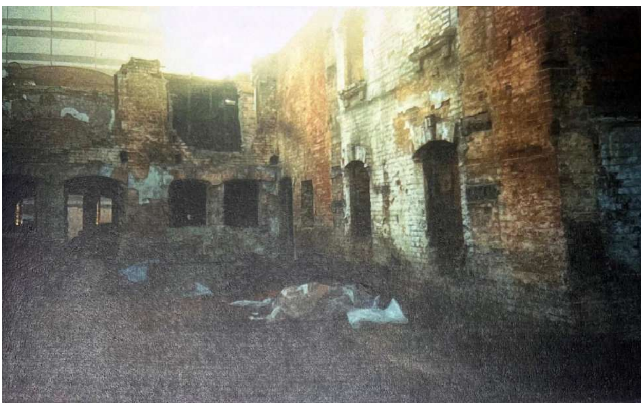
Рис. 39 в, г. Здание переселенческой бани. Дворовые фасады. Фото 2001 г. Источник: Отчет о научно-исследовательской работе «Обследование технического состояния здания бани № 16 по ул. Переселенческой, 27 в Челябинске». Челябинск: ЮУрГУ, 2001
