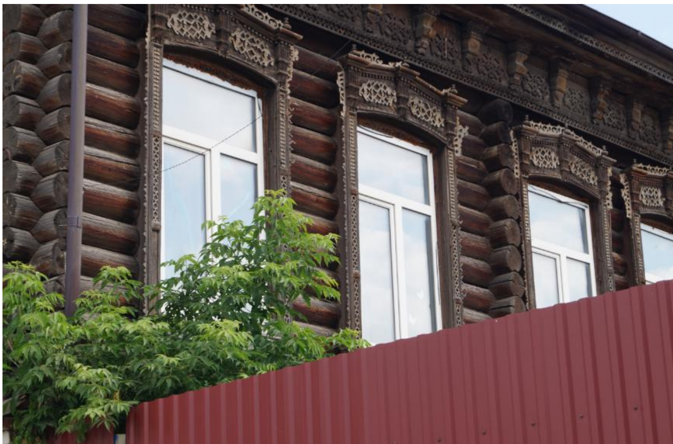
Фото 10. Вид на выявленный объект культурного наследия «Дом торговцев Юркиных», расположенный по адресу: Челябинская область, Миасский городской округ, г. Миасс, ул. Пушкина, 26.
