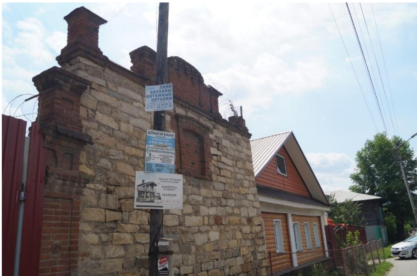
Фото 7. Вид на выявленный объект культурного наследия «Дом торговцев Юркиных», расположенный по адресу: Челябинская область, Миасский городской округ, г. Миасс, ул. Пушкина, 26.
