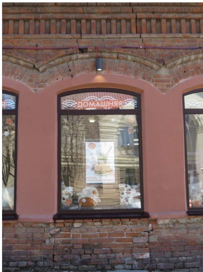
Рис. 4. Фрагмент главного, северного фасада. Средний проем, исторически дверной, в настоящее время – оконный.
