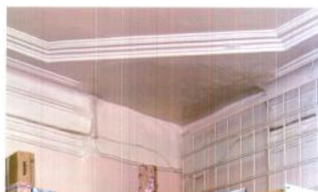
Фото №44. Разобран печь и нарушена орнаментальная композиция карниза стены
