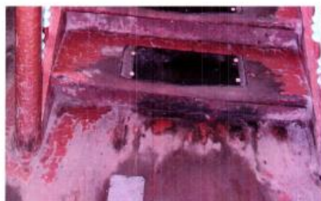
Фото №13. Повреждения окрасочного покрытия ступеней лестницы. Стертость древесины в ходовой части ступеней
