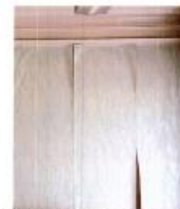
Фото №49. Отслоение обоев от поверхности стены.
