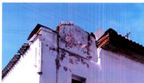
Фото №6. Покрытие кровли в местах свеса частично отсутствует. Переувлажнение кладки в карнизной части стены в местах повреждений покрытия кровли. Гниение подшивной доски карниза.
