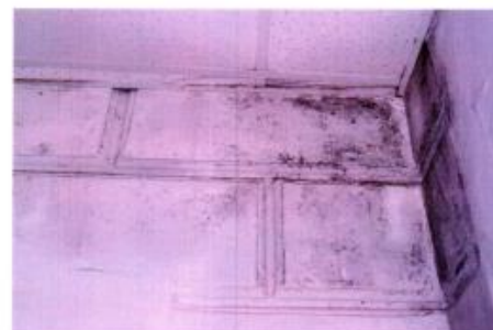
Фото №14. Развитие на поверхности стены в местах замачивания надкры biologicalического разрушения (грибки)
