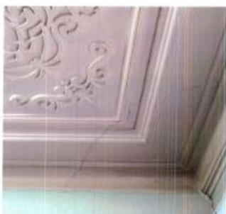
Фото №38. Трещина в орнаментальной отделке лепным декором
