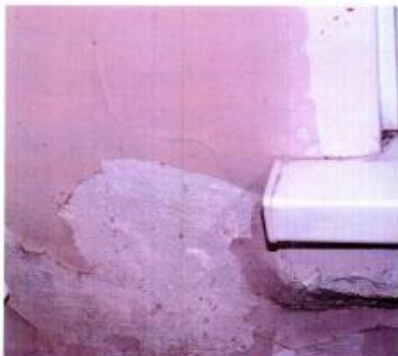
Фото №20. Наработание, растрескивание и обрушение окрасочного покрытия стен.
