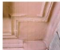
Фото №48. Фрагментарная утрата лепного декора
