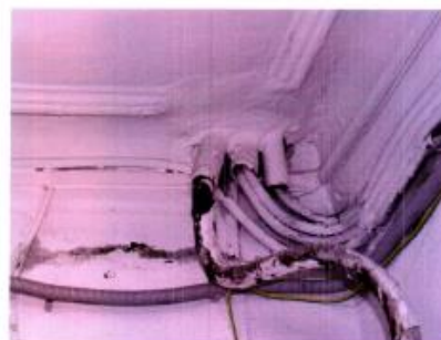
Фото №30. Фрагментарные утраты лепного декора потолка. Профилированные тяги имеют сколы и печатные грани архитектурных обломов тяг
