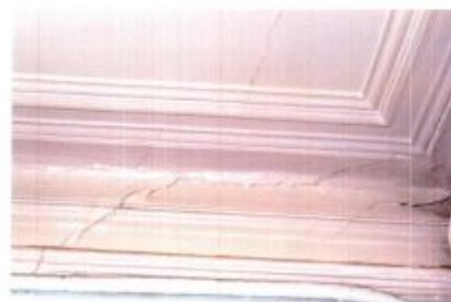
Фото №53. Трещины в орнаментальной отделке лепным декором. Нечеткие грани архитектурных обломов потолочных тяг
