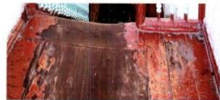
Фото №32. Повреждение лакокрасочного покрытия пола
