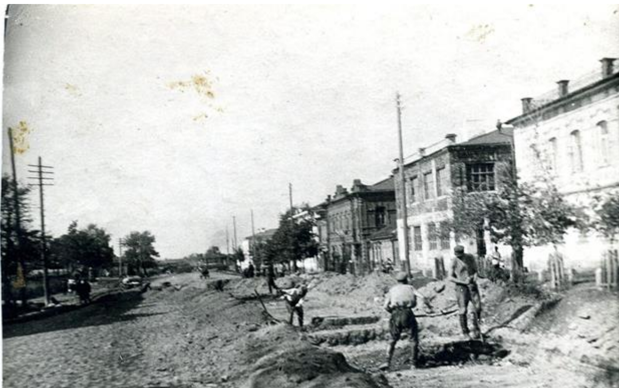
Улица Цвиллинга. Строительство трамвайных путей. Справа надстроенный флигель Покровских (не оштукатурен второй этаж). Фотография начала 1930-х гг.
