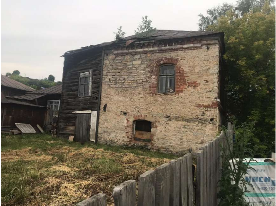
Фото 4. Восточный фасад Объекта. Дворовая территория. В деревянном пристрое размещается лестница. Оконный проем и проем входа в подклет имеют лучковую форму. 08.07.2020г.
