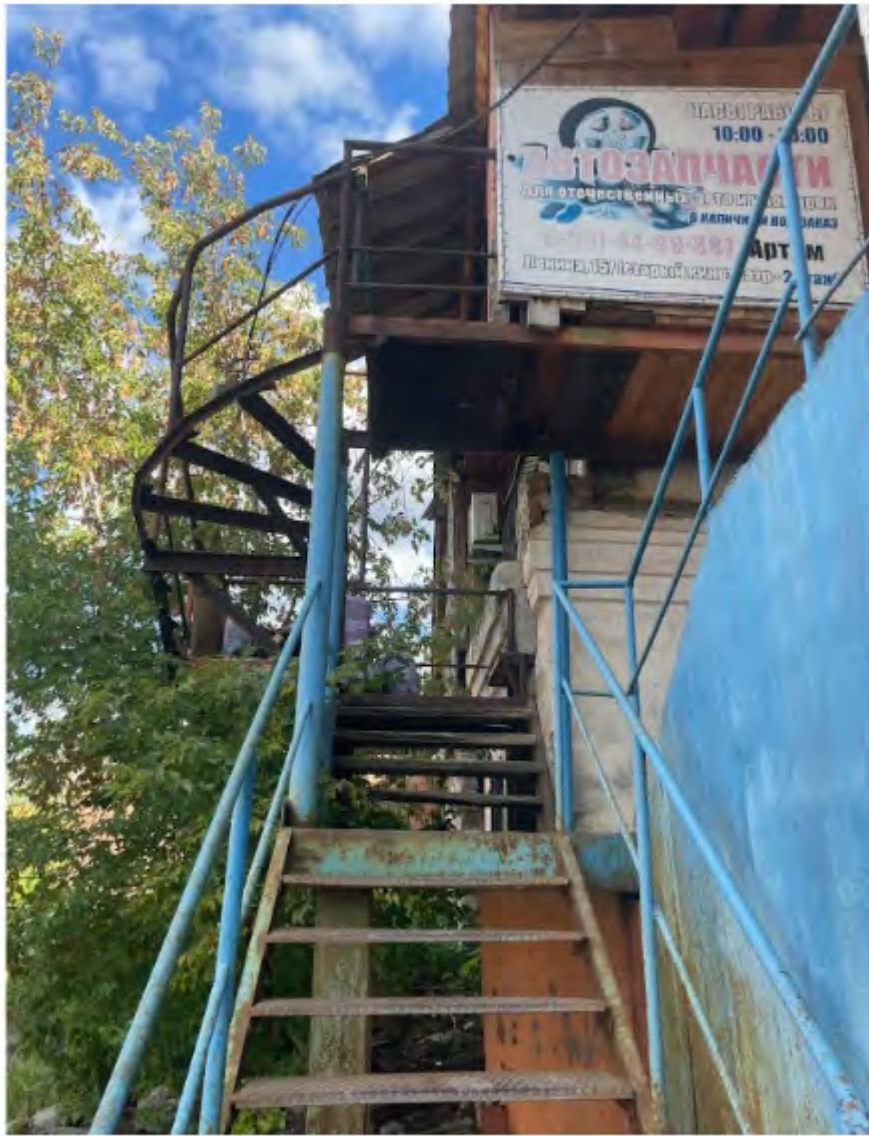
Фото 16. Выявленный объект культурного наследия «Дом купца Прохорова Н.Г.» по адресу: Челябинская обл., г. Верхний Уфалей, ул. Ленина, 157. Фрагмент северного фасада выявленного объекта культурного наследия.
