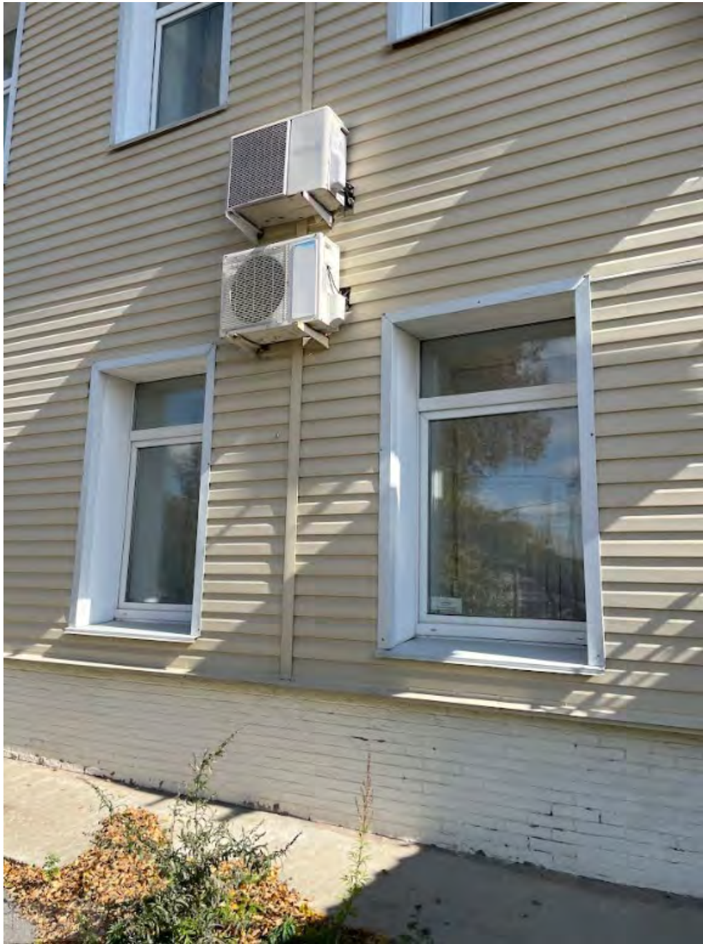
Фото 7. Выявленный объект культурного наследия «Волостная управа» по адресу: Челябинская обл., г. Кыштым, ул. Советская, 29. Фрагмент фасада выявленного объекта культурного наследия в восточном направлении.
