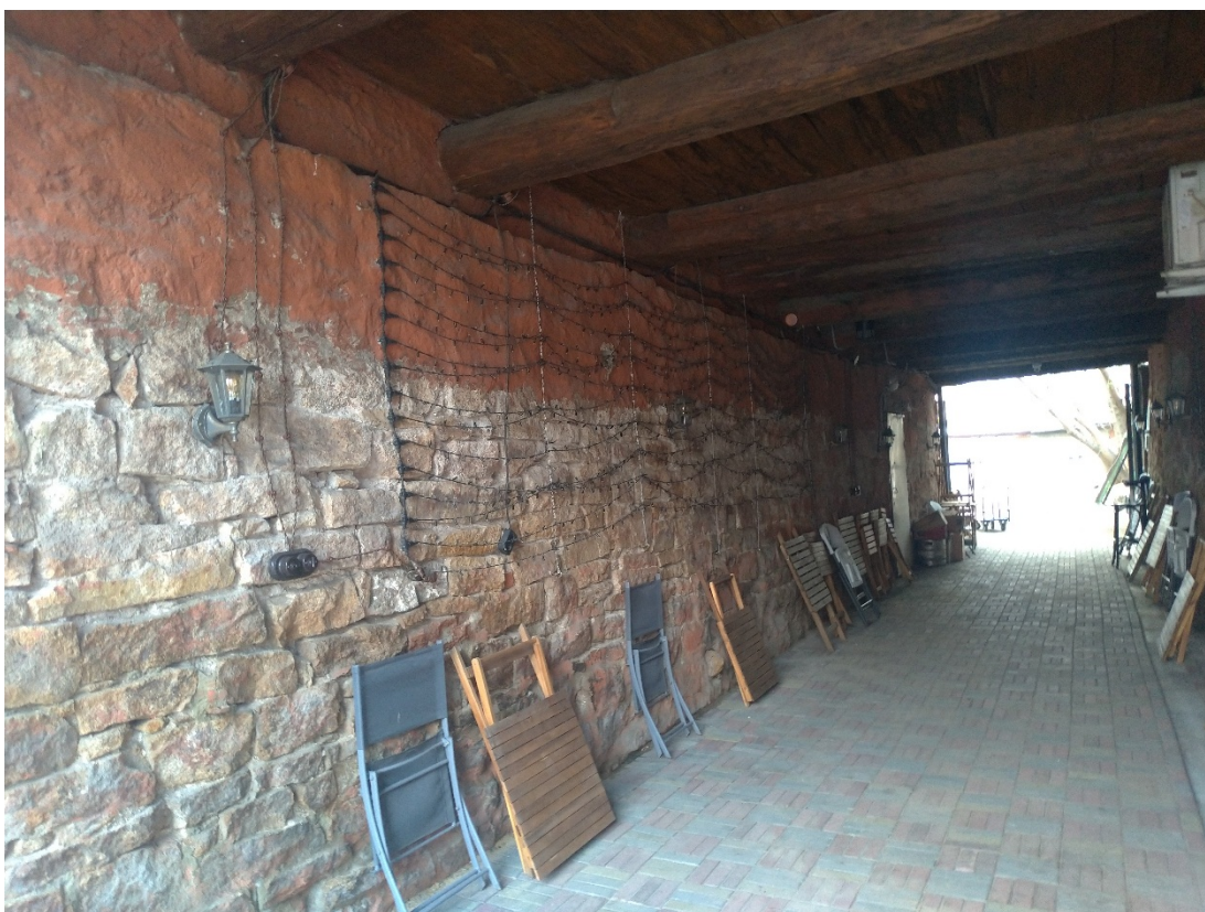
Приложение №10. «Дом купеческий Шарлова». Бутовая кладка проезда и деревянное балочное перекрытие. Вид с востока. Фото май 2022 года.
