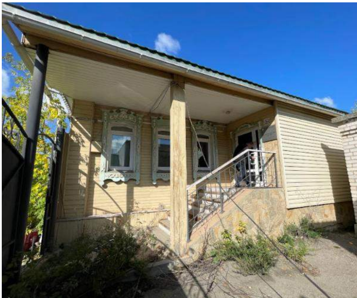
Фото 5. Выявленный объект культурного наследия «Дом купца А.Н. Якушева» по адресу: Челябинская обл., г. Верхний Уфалей, Каслинская ул., 1. Фрагмент южного фасада выявленного объекта культурного наследия.
