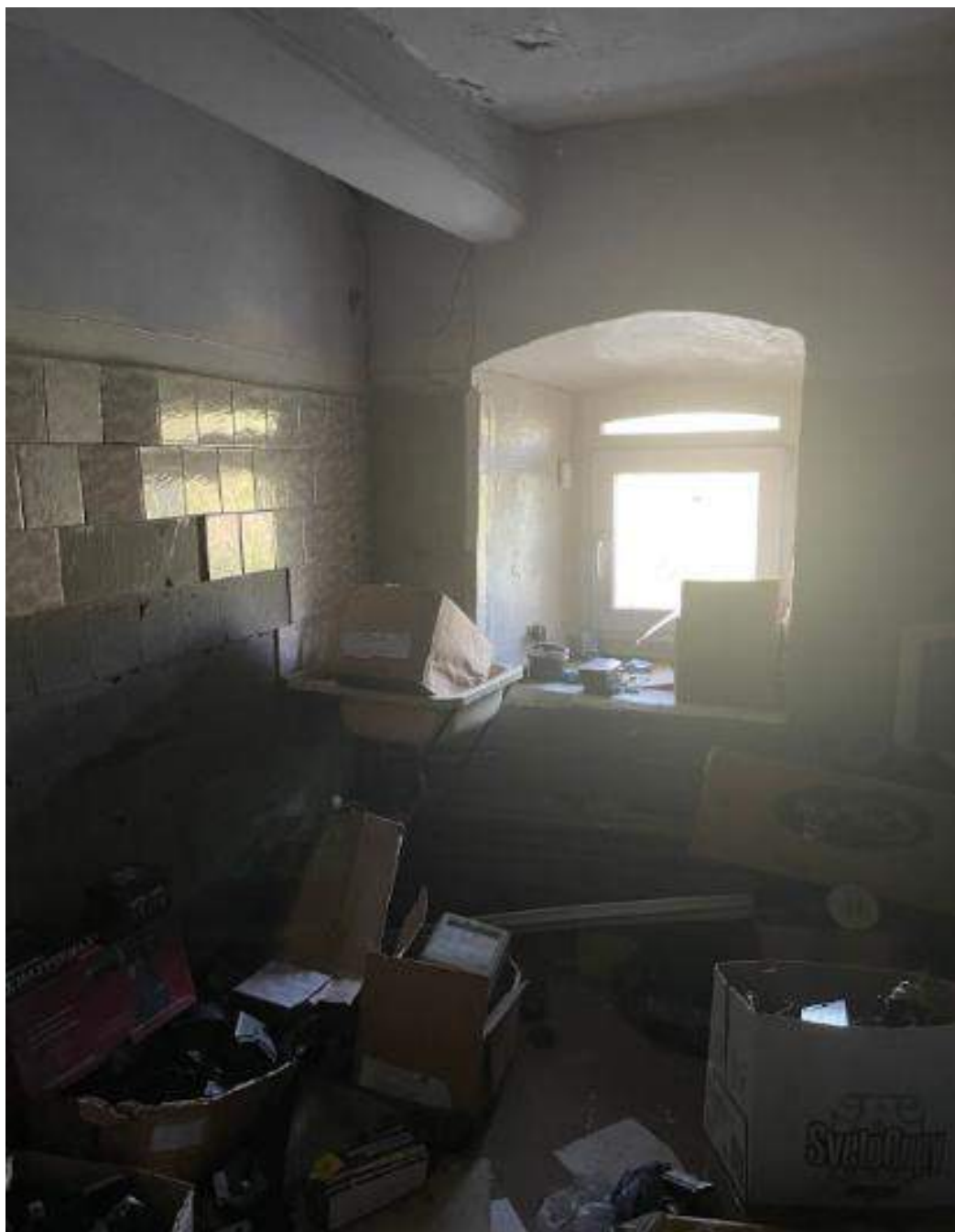
Фото 45. Выявленный объект культурного наследия «Дом купца А.Н. Якушева» по адресу: Челябинская обл., г. Верхний Уфалей, Каслинская ул., 1. Интерьер выявленного объекта культурного наследия. Помещение 8. Цокольный этаж.
