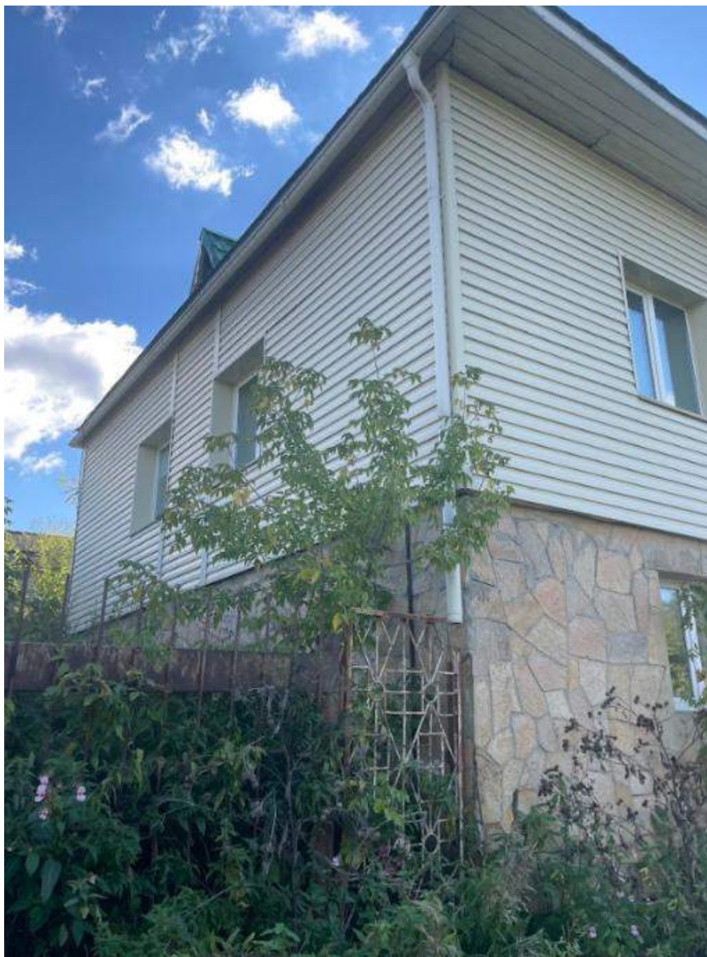
Фото 17. Выявленный объект культурного наследия «Дом купца А.Н. Якушева» по адресу: Челябинская обл., г. Верхний Уфалей, Каслинская ул., 1. Фрагмент восточного фасада выявленного объекта культурного наследия.
