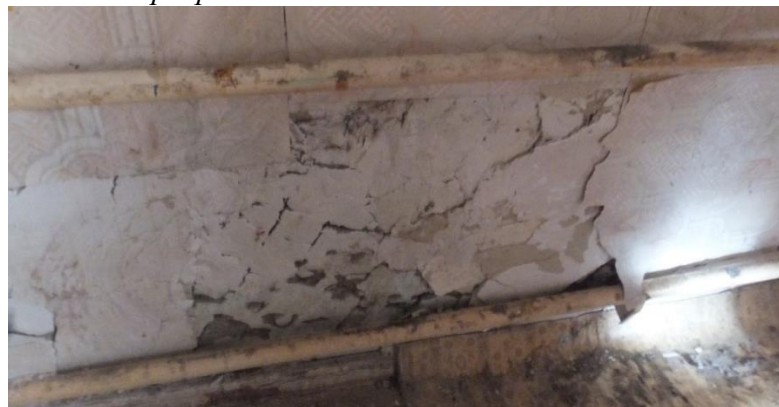
Состояние стен в интерьере третьей комнаты выявленного Объекта. Фото 2023г.
