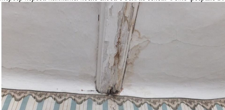
Состояние балки в интерьере комнаты выявленного Объекта. Фото февраль 2023г.
