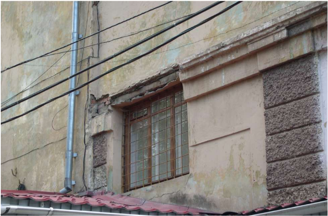
Рис.34 Вид на пробитое окно над пристроем в южной части западного фасада.
