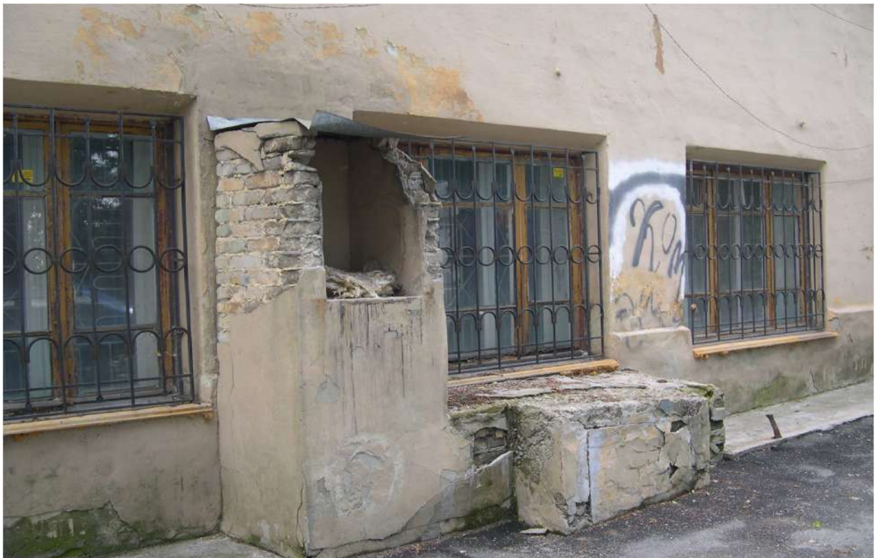
Рис.33 Вид на полуразрушенный элемент вентиляции на западном фасаде.
