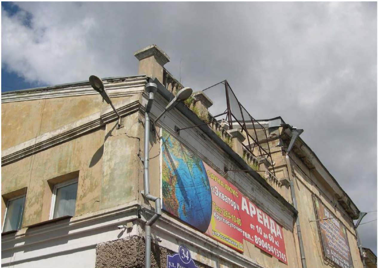
Рис.27 Вид на разрушенный юго-восточный угол здания.
