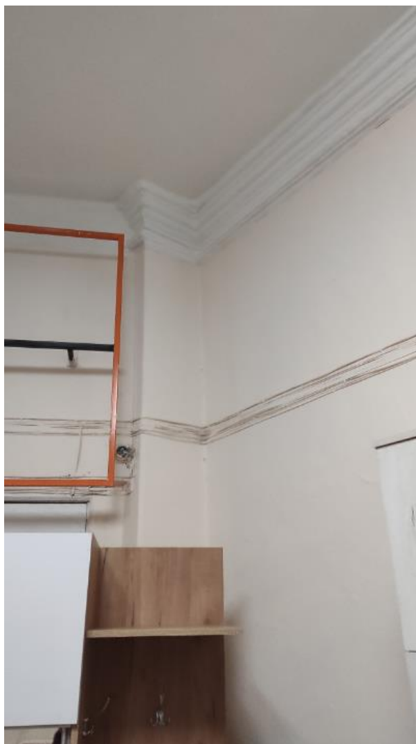
Фото 19. Интерьер выявленного объекта культурного наследия «Магазин Стахеева», расположенного по адресу: Челябинская область, Миасский городской округ, г. Миасс, ул. Ленина, 2.
