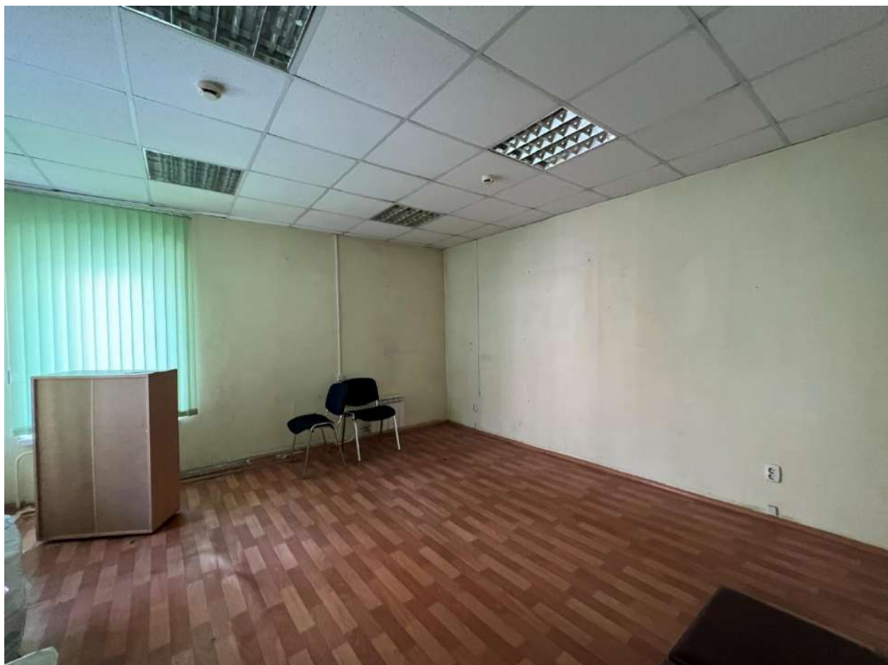
Рис. 15. Фрагменты интерьера второго этажа. Помещение с заложенным историческим окном в левом, восточном дополнительном объеме
