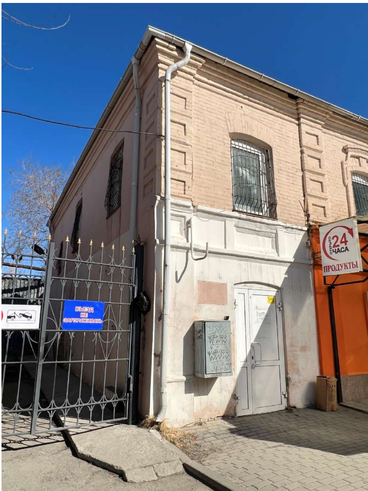
Рис. 4. Фрагмент главного фасада и боковой, западный фасад. Лестничный объем. Вид с юго-запада
